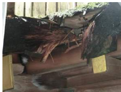
アライグマによる建物損壊の被害
